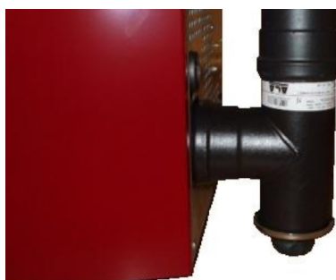
Fig. 87 - Pulizia canale da fumo
