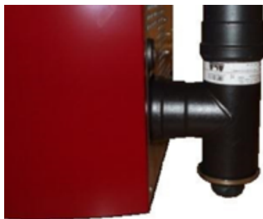
Fig. 87 - Pulizia canale da fumo
